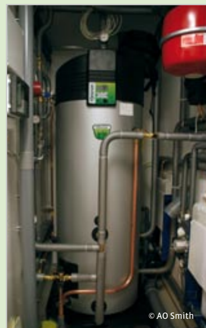
AO SMITH // Zonneboiler van 57 kW en 370 liter (verwarmd door 2 zonnepanelen)
